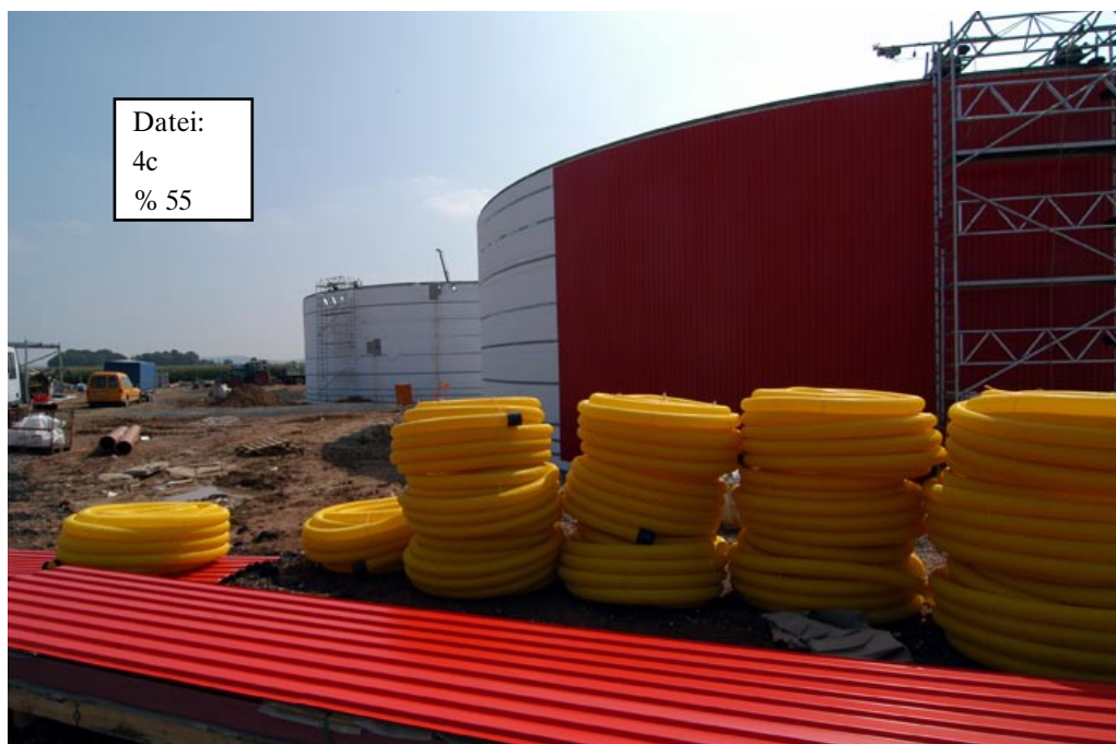
Beim Bau einer gemeinschaftlichen Biogasanlage kann die neue Rechtsform interessant sein (siehe Beispiel 1). Fotos: landpixel.de, Meyer
